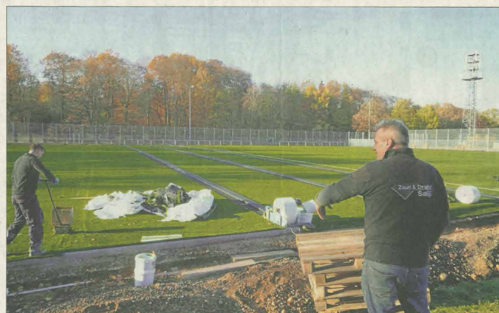
Der neue Kunstrasen wird auf dem Sportplatz in Villiprott verlegt. Damit neigt sich die Sanierung dem Ende entgegen.
